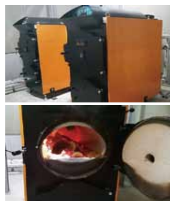
この度導入された薪ボイラー ガシファイヤー
